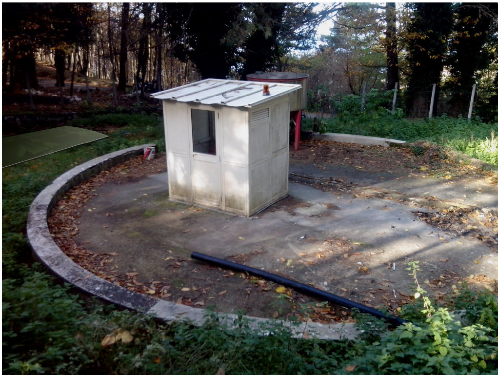
Figg.60-61 – Stato di fatto (sopra) e stato di progetto (sotto) del nuovo impianto di sollevamento in località Villaggio Monte Faito, nella sede dell'ex impianto “Co.Mo.F.”
